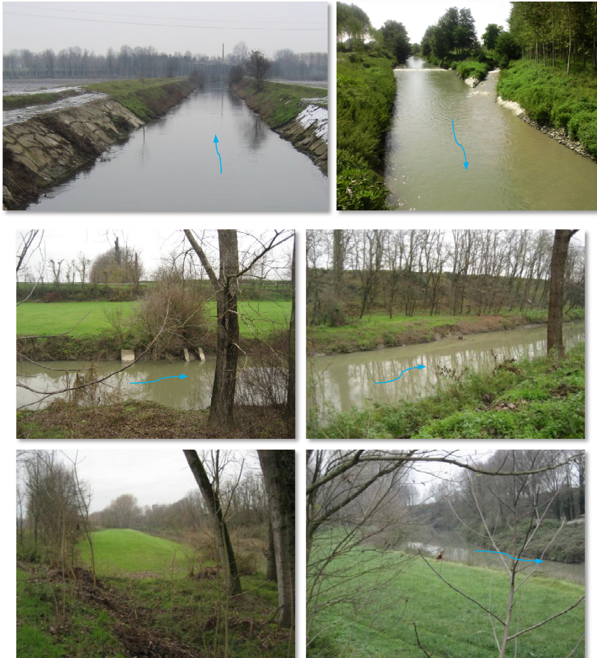
Figura 19: Canale Allacciante con rivestimenti ammalorati a valle del ponte del Mezzano; Canale Gandiolo a valle della confluenza del Colatore Guardalobbia; tratto circa 740 m e a valle del ponte del Fornasotto: in evidenza un manufatto trasversale e lo scolo del ramo secondario alimentato da acque della Cotta Baggia Morara (secondo la ricostruzione fornita); erosione di sponda intorno a un manufatto trasversale in corrispondenza del confine con Corno Vecchio; panoramica area golenale a valle della ripresa precedente; tratto a debole sinuosità 150 m circa a monte del ponte della SP 195.
