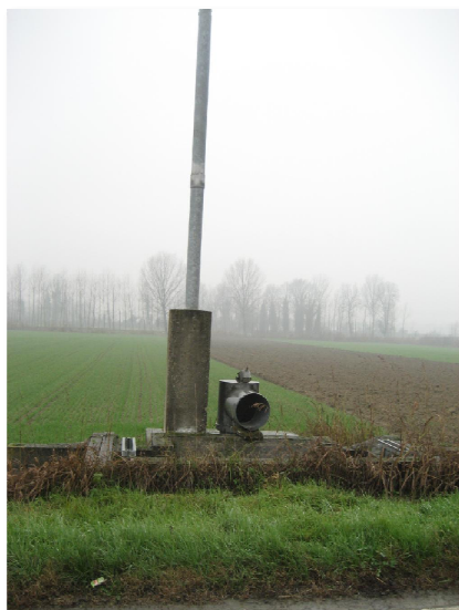
Figura 18: sfizio di un dissipatore idraulico della rete in pressione e idrante che scarica nella rete di adacquatrici.
