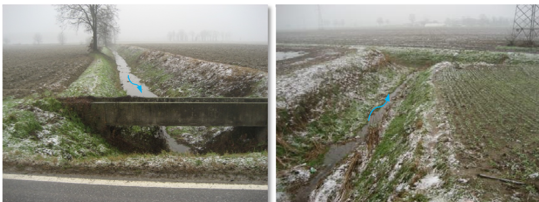
Figura 21: Mezzano Passone nel tratto terminale, prima di passare sotto la strada del Quartierone, e lo scarico nel Seriole.
