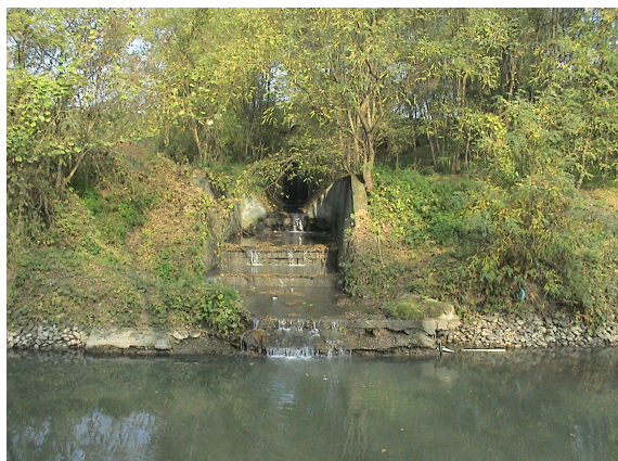
Figura 16 Scarico del colo Trecco nel canale Gandiolo
