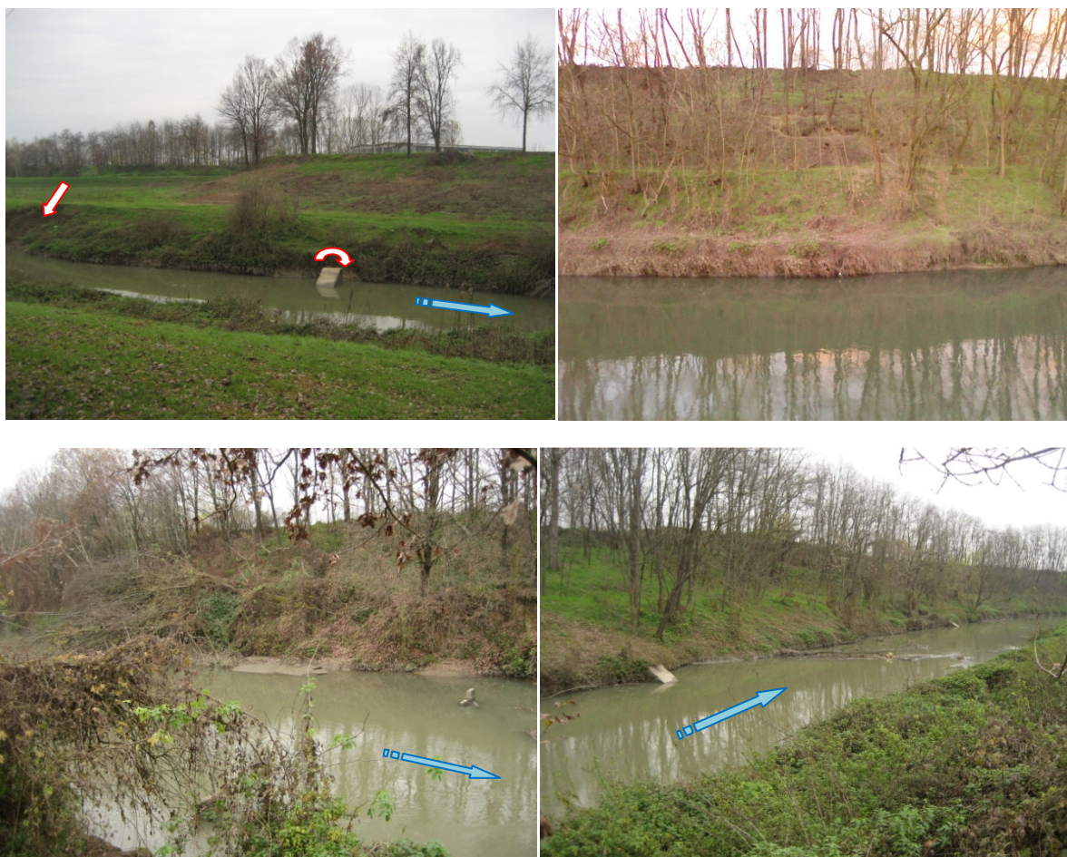
Figura 65: stato della scarpata principale.:
